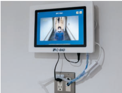
放射線治療室に向かう廊下に設置された顔照合システム。アクセサリ照合機能と併せて、ヒューマンエラーを防ぐとともに、スタッフの心的負担軽減に貢献している。
