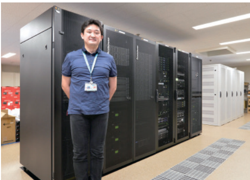
千葉大学医学部附属病院のサーバ室。2018 年のハードウェア更新で仮想化・統合化による IT 基盤を整備。従来のシステムに比べ、大幅なコンパクト化に成功している。
