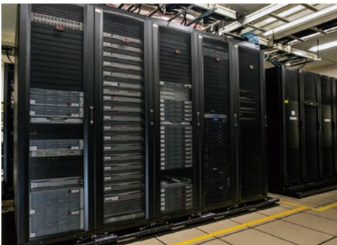
HISのサーバ群。サーバ、スイッチ、ストレージの3層構成の仮想化環境を1つの機器に集約して、システム室の占有スペースを3分の1程度にまで縮小するなど、ソフト面だけでなくハード面でも最先端の医療ITを活用している
