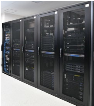
病院内にある電子カルテシステムサーバ。約5年間分の保存容量を確保し、データベースエンジンに「Cache（キャッシュ）」を採用、蓄積、保存したデータを高速処理する
