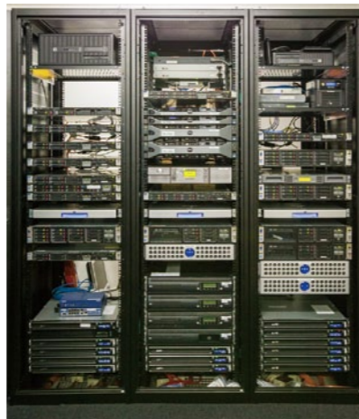
病院内にある電子カルテシステムサーバ。4TBの容量を持ち、約10年間分のデータ保存容量を確保。過去データについても参照用データとしてシステムサーバ内に保存している
