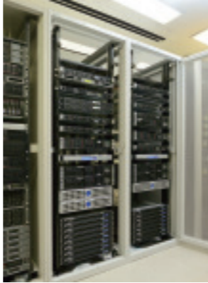
サーバ室。システムサーバは集約化され、2本のサーバラックに収まる容量を実現している
