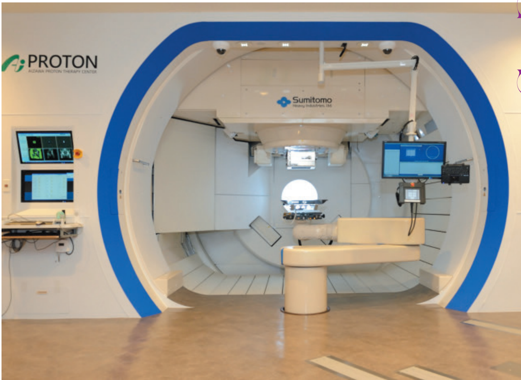
インルーム CT や 6 軸補正可能なロボット寝台、フラットパネル X 線撮影装置など、多彩な機能によって高精度な照射を可能としたガントリ照射室。近い将来にはガントリ内に設置した PET 検出器による照射線の検証なども実施可能となる
