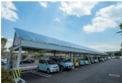
同院では、市道病院前線側にハイブリッド街路灯（風力・太陽光発電システム）を3機設置。歩道の照明に使用することにより、夜間の歩行者の安全に寄与している（写真上）他、駐車場には太陽光発電装置を設置し（写真下）、地球環境への配慮も行われている
