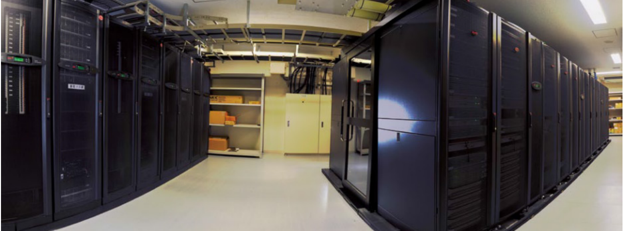
海南病院のサーバ室。20本のサーバラック「NetShelter SX」と冷却装置「InRow RC」6セットを組み合わせたHACSを構築。システムごとに導入されていた小型UPSをUPS「Symmetra PX 40kVA/40kW」4セットに集約し、省スペース化を実現している
