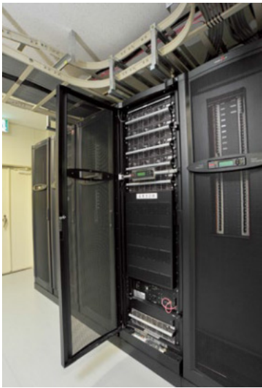
常時インバーター（オンライン）方式三相UPS「Symmetra PX 40kVA/40kW」を2台×2セット導入、完全に冗長化された2系統の電源により安定稼働を実現
