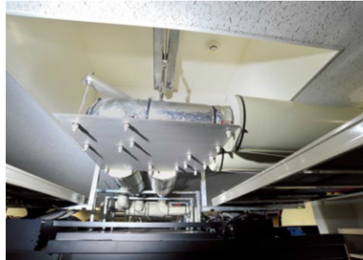
水冷式の冷却システムを採用することで、電気代を大幅に低減。漏水対策は必要なもの、大きなトラブルは起きていないという
