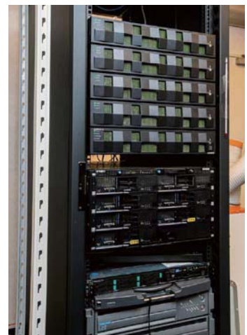
仮想化によって集約されたサーバラック。物理サーバの台数を大幅に削減、消費電力も1/3以下に低減させるなど、システムのダウンサイジングを実現している
